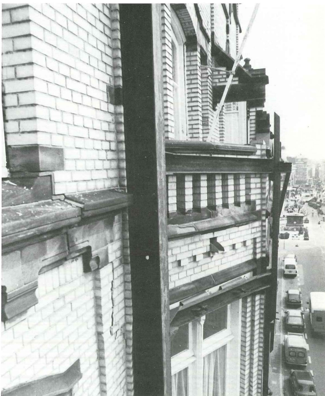
16. De schade aan de voorgevel door roestend ijzerwerk.
