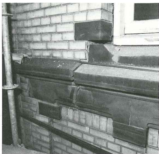
15. De schade aan de voorgevel door roestend ijzerwerk.
