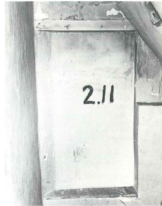
8. Een dichtgemetselde raamopening in de zijmuur van Nobelstraat 3
