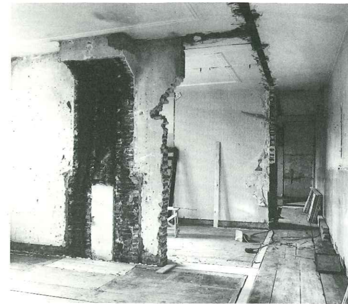
21. De woninkjes op de verdieping van de nieuwbouw uit 1870 (nrs. 55 t/m 59) tijdens de renovatie van 1987. Van het oorspronkelijke interieur zijn de eenvoudige stucplafonds, een rookkanaal en de houten vloerdelen te zien.
