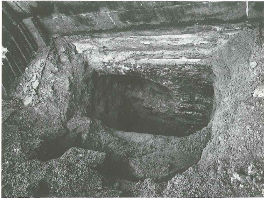
Funderingsonderzoek in de Boterwaag, Prinsegracht 1a, naast de poort: onder de zandstenen wanden bleken gemetselde spaarbogen te staan.
