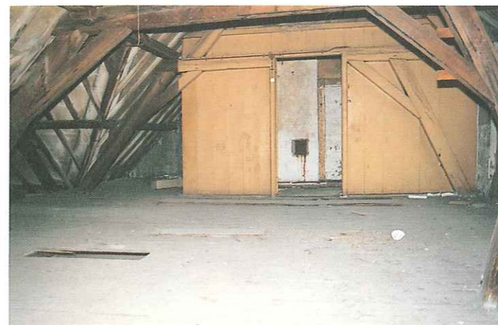
23. Kapspanen van pand Rivierovismarkt 3 in de toestand vóór 1986.
