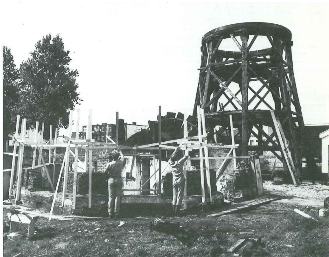
20. De opbouw van de stenen voet, op de achtergrond het schoongestralde achtkant, 29 augustus 1986.
