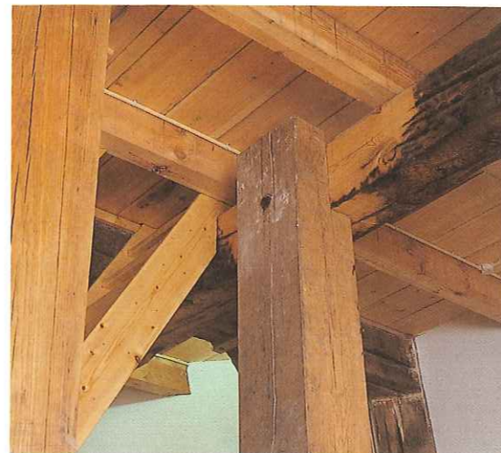
34. Detail constructie op eerste zolder. Zichtbaar is een hergebruikte, door brand zwart geblakerde vloerbalk.
