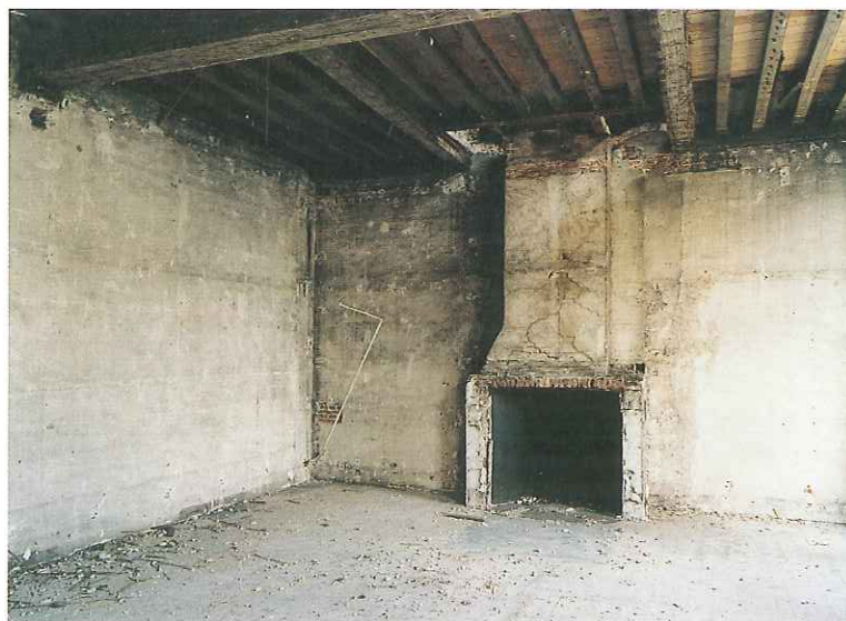
61. Pand nummer 4. Eerste verdieping. Een der vertrekken met moer- en kinderbinten. Toestand voor de restauratie.
