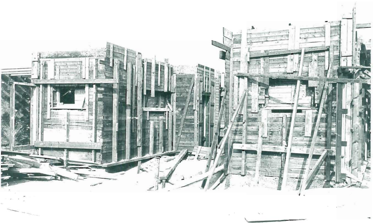
102. '...is een ruwe houten bekisting zonder systeem toegepast..' (boven)
