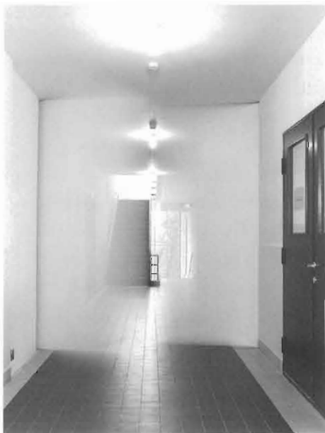
De vereiste automatische branddeuren.
