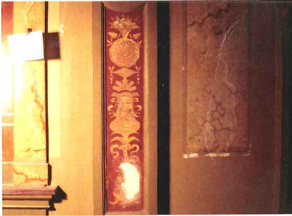
Na het verwijderen van de radiator is een grote beschadiging ontstaan.
